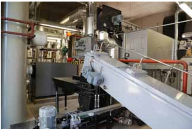
Heizzentrale zwischen Sport- und Feuerwehrhalle mit Holzhackschnitzel- und Ölzusatzheizung
