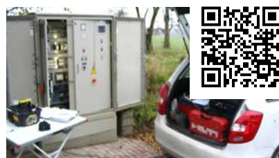
Armoires électriques hébergeant les commandes
