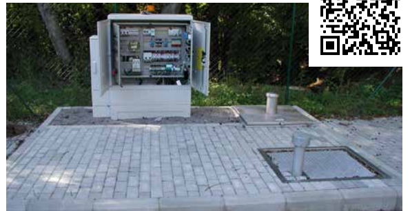
Vue extérieure sur l'armoire électrique des commandes
