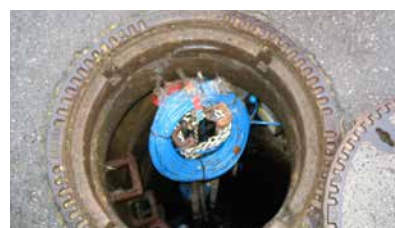
Regard de la station de pompage « Dielchen »
