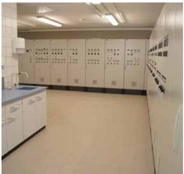
Vue sur les armoires électriques
